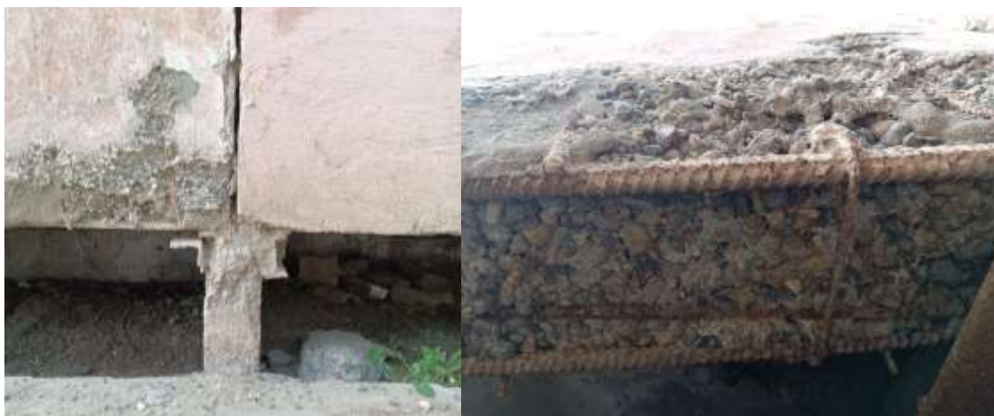
6-rasm. Binoning temirbeton konstruksiyalaridagi armaturani himoya qatlamini yemrilishi.
